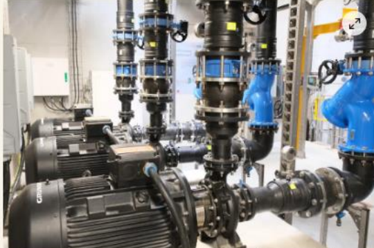
L'eau de mer est captée dans le port, transite par des échangeurs thermiques, puis retourne à la mer sans aucun impact environnemental. © La Grande Motte
