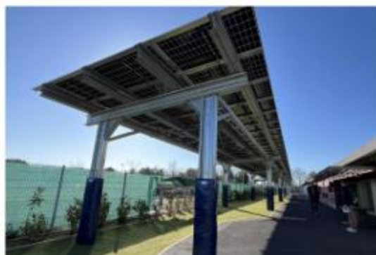
Centrale photovoltaïque installée à la Maison des enfants à Mauguio (34).
